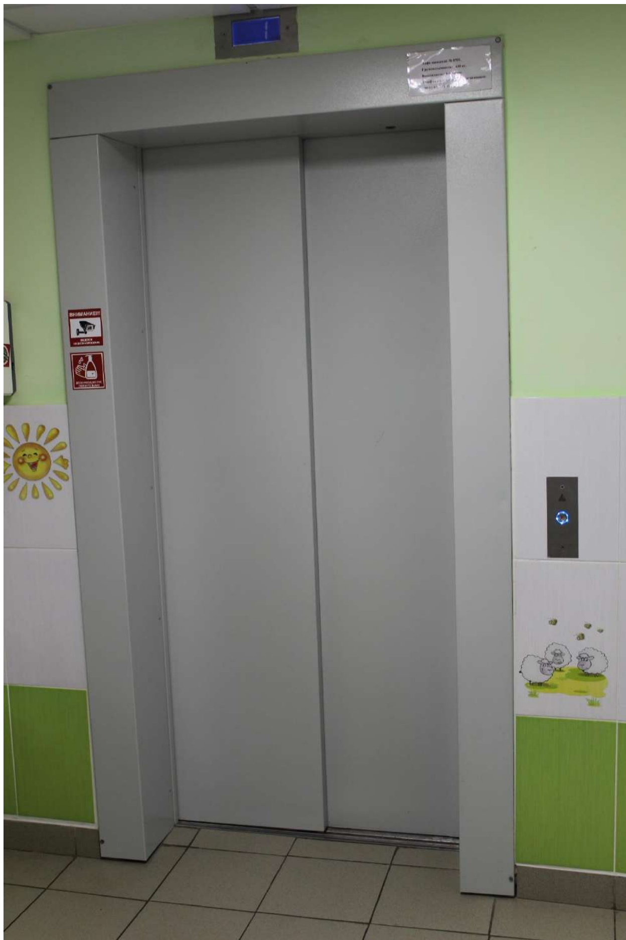
ФОТО № 23 ЛИФТ ПАССАЖИРСКИЙ (ИЛИ ПОДЪЕМНИК)
